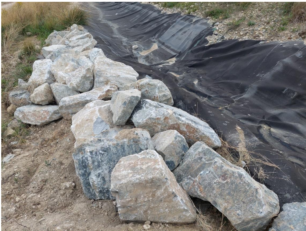
Photo 1 : Enrochements désordre A01
