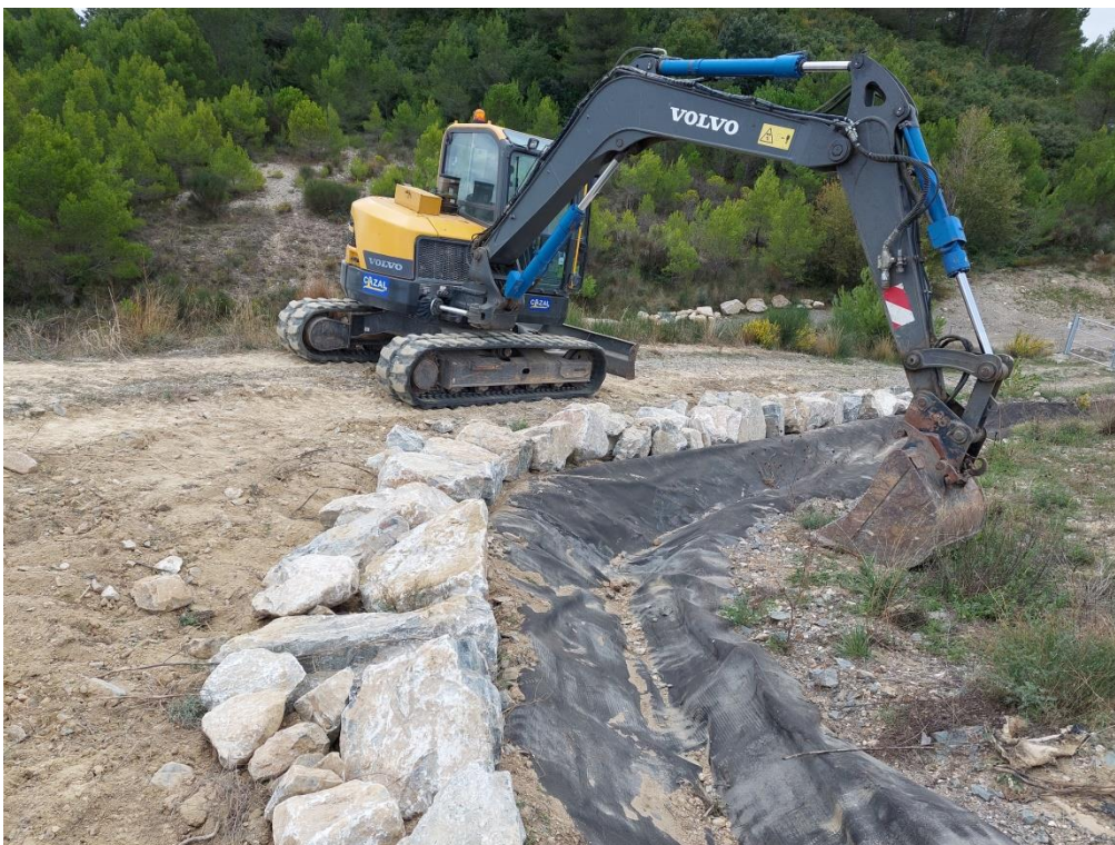
Photo 6 : Enrochements désordre A07
