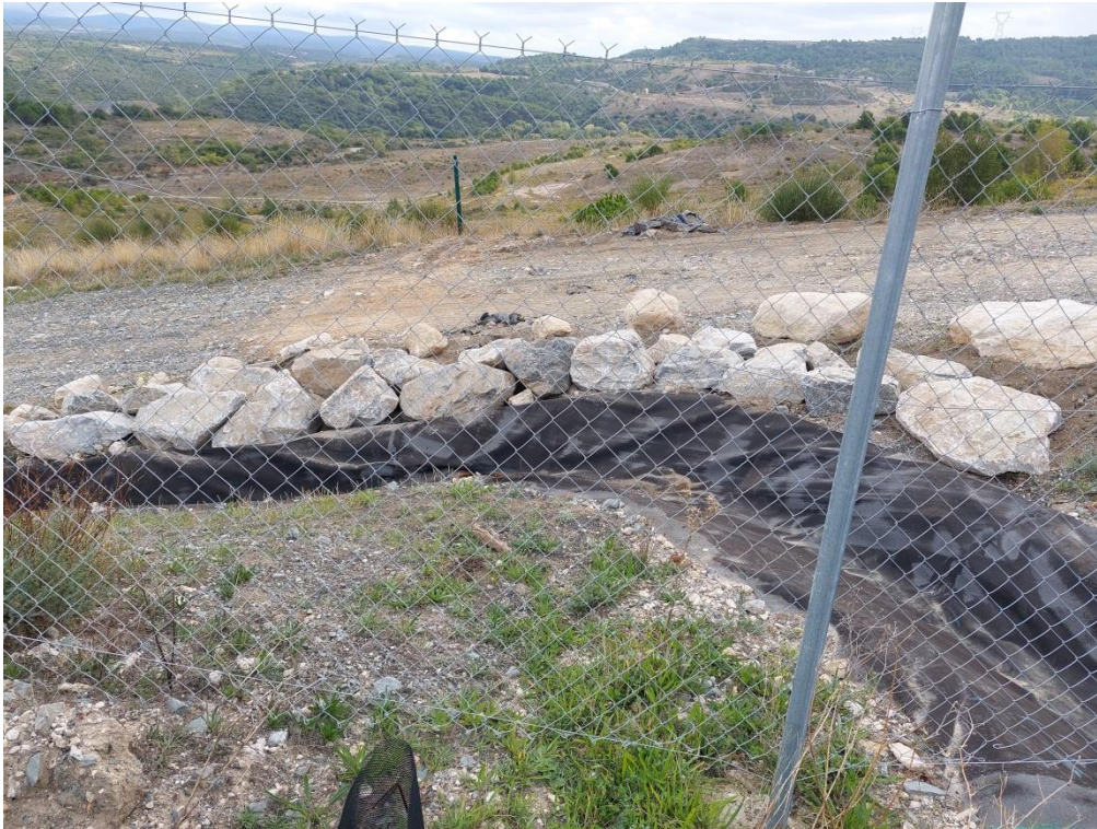
Photo 5 : Enrochements désordre A06
