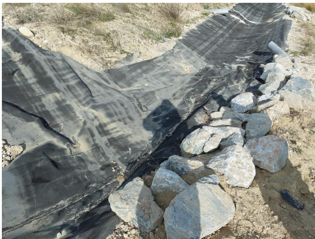
Photo 4 : Enrochements désordre A04 à prolonger en amont
