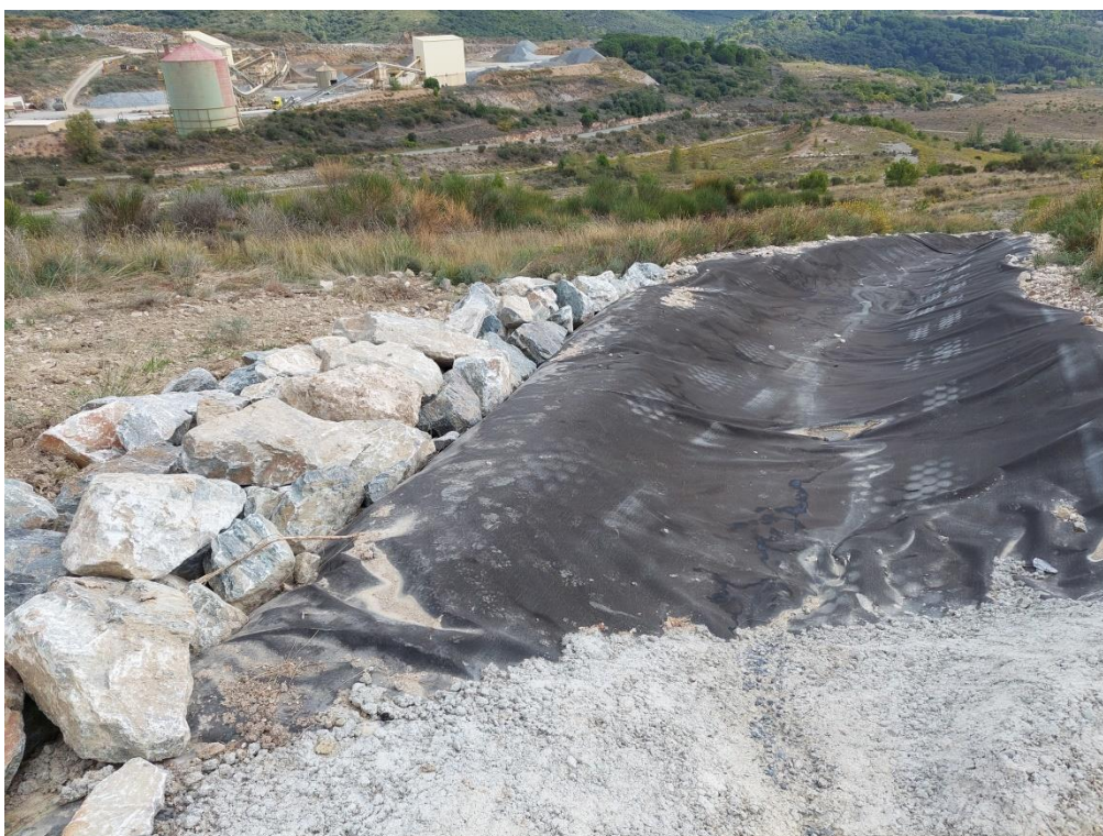
Photo 2 : Enrochements désordre A02
