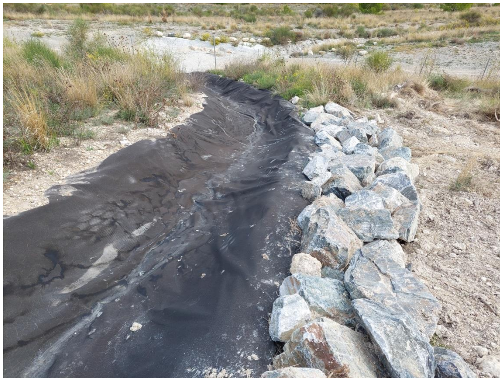
Photo 3 : Enrochements désordre A03 à rehausser en amont de quelques enrochements
